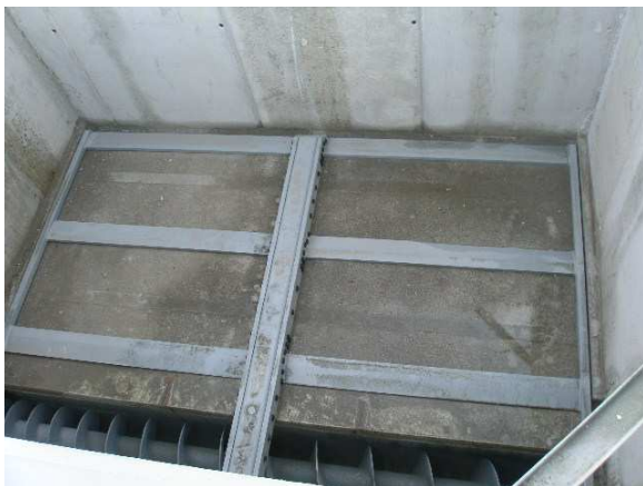
Sistema Extractor Tolvas de Recepción
