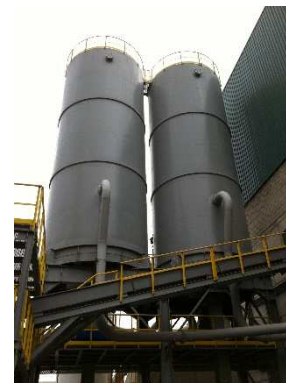
Silos de Fango Deshidratado
