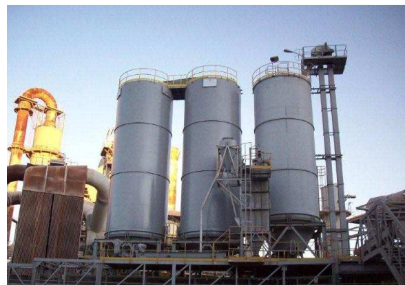
Instalación línea de secado y alimentación a horno CEMEX Planta de San Vicente del Raspeig
